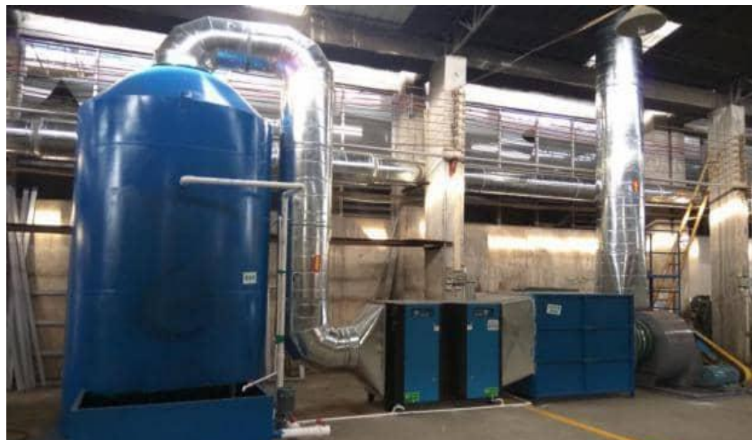
废气处理系统
